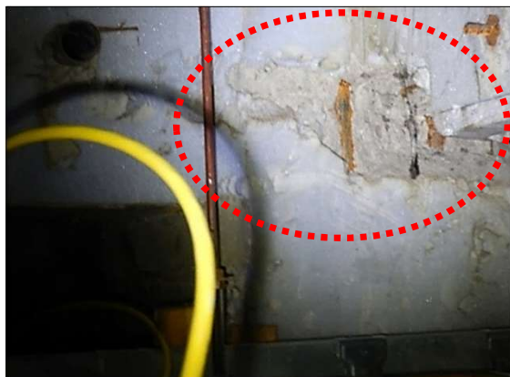
1階事務室(天井裏) 柱と梁の接続部において、鉄筋が露出し錆が進行している。
