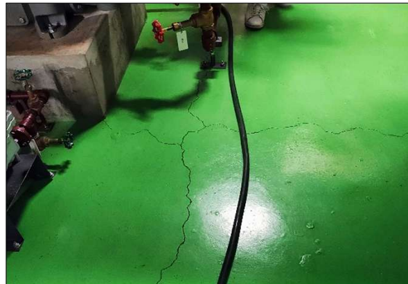
ボイラー室 床にクラックが発生している。
