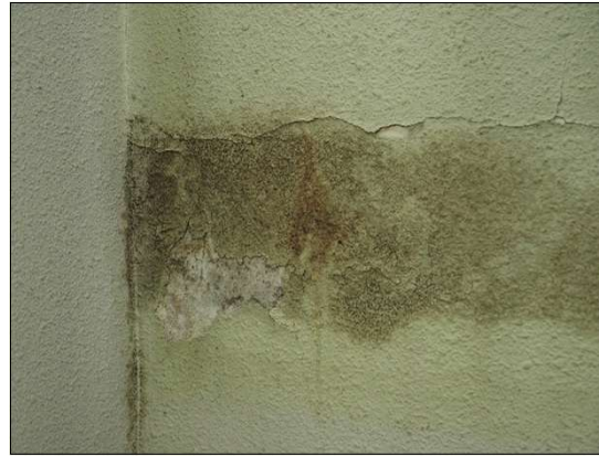
内壁 外壁からの漏水が発生している。
