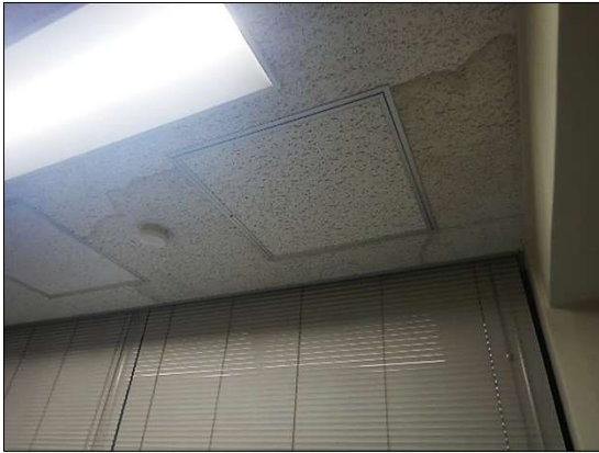
1階事務室 天井に漏水が発生している。
