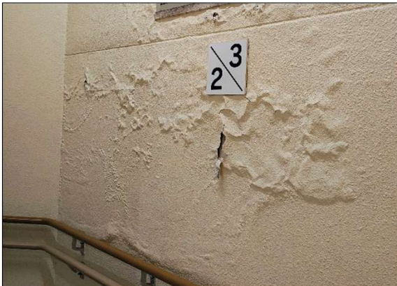
階段室 塗装膨れが発生している。
