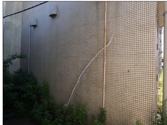
東面外壁 壁面タイルに大きなクラックが発生している。
