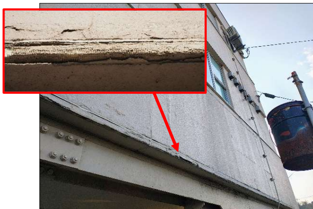
外壁 塗装剥離が発生し、断熱材が露出している。
