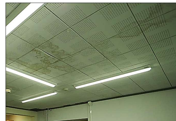
図書資料室 天井に漏水が発生している。
