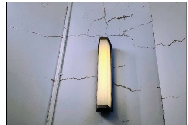
階段室 壁にクラックが発生している。
