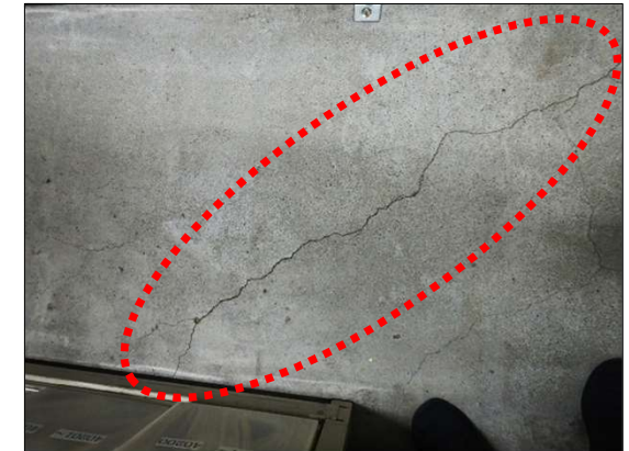
2階書庫 床にクラックが発生している。
