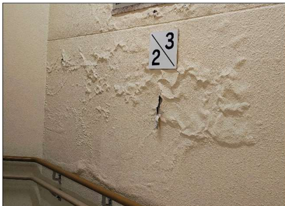
階段室 塗装膨れが発生している。
