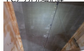
光ファイバセンサによる 橋梁モニタリング
