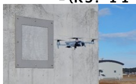
ドローンによる損傷把握
