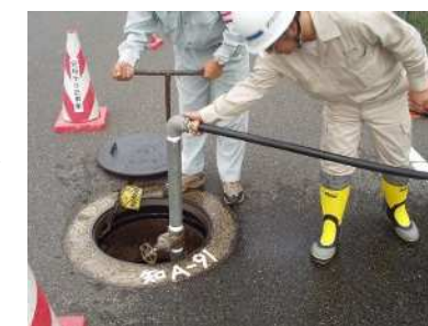
応急給水支援設備
