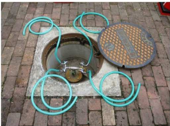
地下式給水栓
