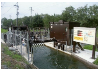
小水力発電設備 (富山県)
