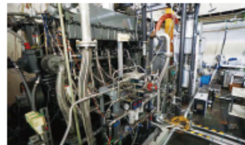
ガスエンジン
