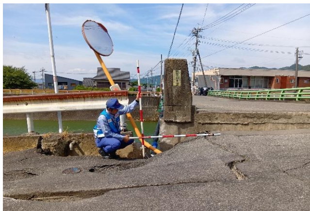
道路の被災状況調査（氷川町）
