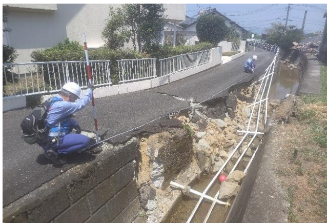
道路の被災状況調査（氷川町）
