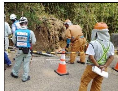
現地調査(橋台背面の崩壊箇所) 【TEC-FORCEパートナー】
