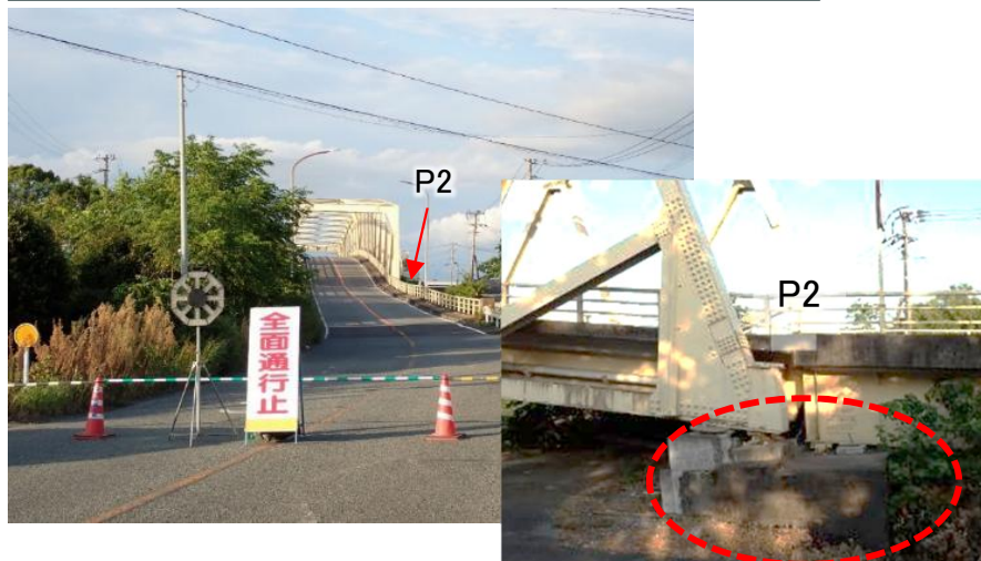
橋脚の傾斜・沈下
