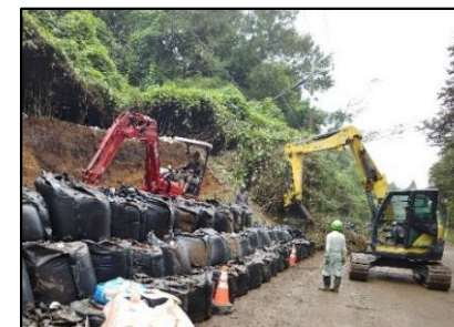
緊急復旧(土砂流出箇所) 【TEC-FORCEパートナー】
