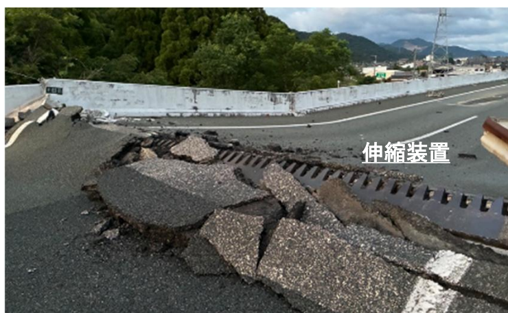
【川田橋の被災状況】
