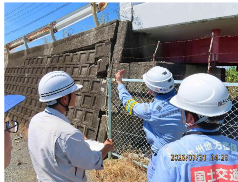
▲7月31日_八代市内の損傷した橋梁の現地調査
