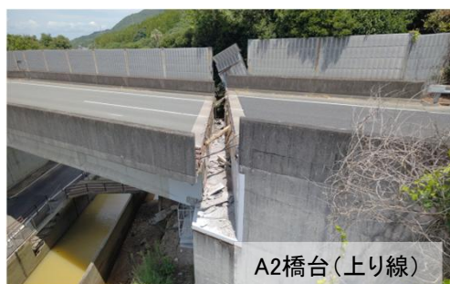
損傷状況(橋桁のずれ)
