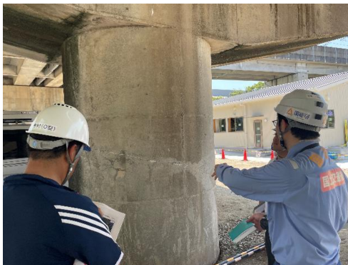
▲8月1日宇土市内の損傷した橋梁の現地調査状況
