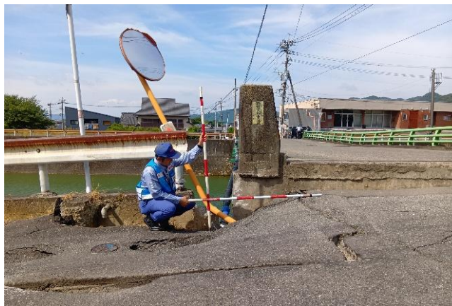
ひかわちよう 道路の被災状況調査 (氷川町)
