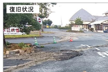
被災した駐車場の応急復旧 (道の駅竜北(氷川町))
