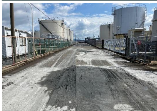
液状化による噴砂
