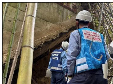
現地調査(橋台背面の崩壊箇所) 【国土技術政策総合研究所 ・土木研究所】
