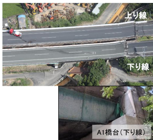
損傷状況(橋桁の座屈)
