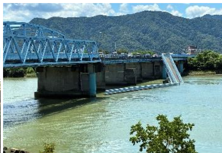
下流側側道(歩道部)の落橋
