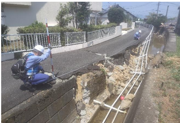
道路の被災状況調査（氷川町）
