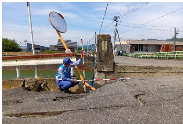
道路の被災状況調査（氷川町）
