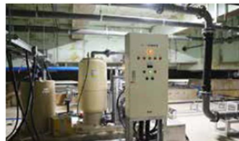
▲雨水を貯めてトイレ用水などとして使用するための雨水利用施設
