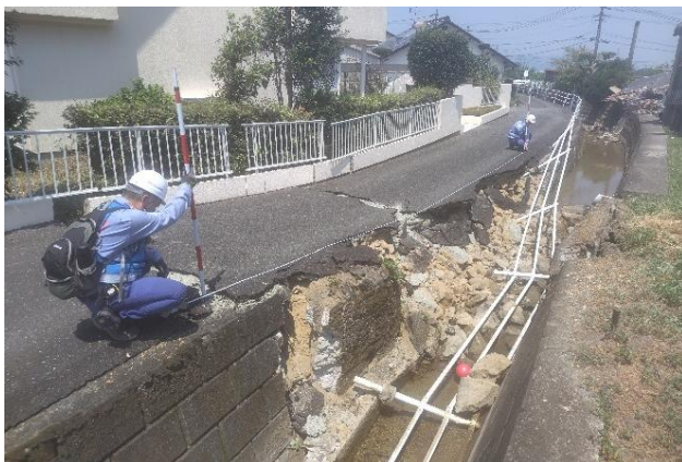
道路の被災状況調査（氷川町）
