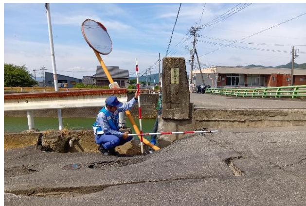
道路の被災状況調査（氷川町）
