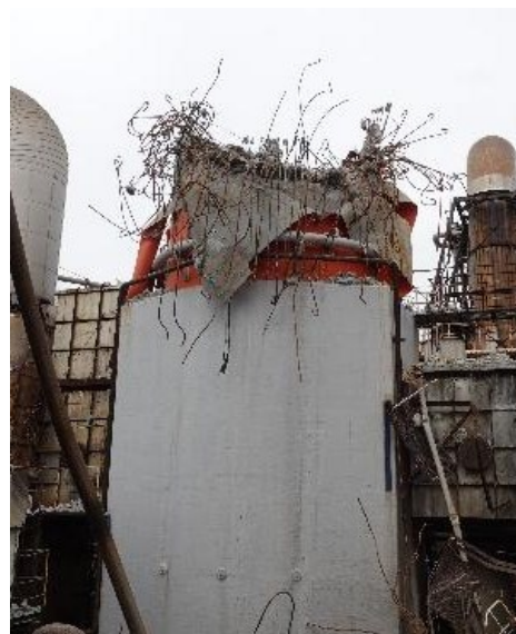
煙突①の折損部拡大
