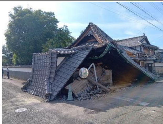
社寺建築物の倒壊
