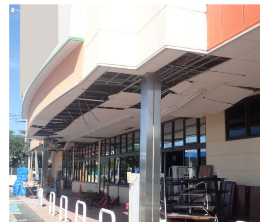
軒天井の天板の脱落
