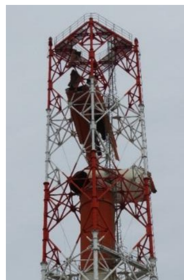
折損したFRP製円筒
