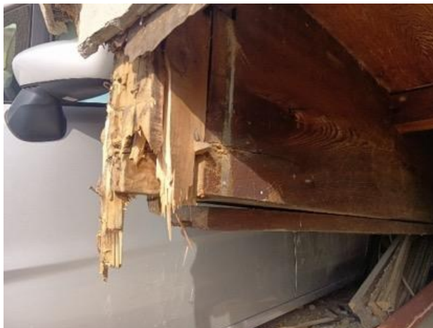
通し柱-大梁の接合部での破断
