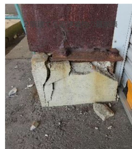
柱脚部の被害
