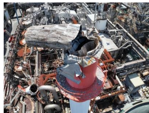
煙突②の折損部断面
