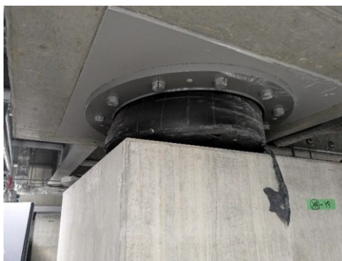
支承材の積層ゴム部の被害
