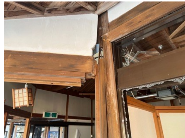
梁端部の脱落
