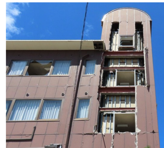
ALCパネルの脱落
