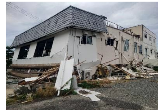
鉄骨造建築物の層崩壊
