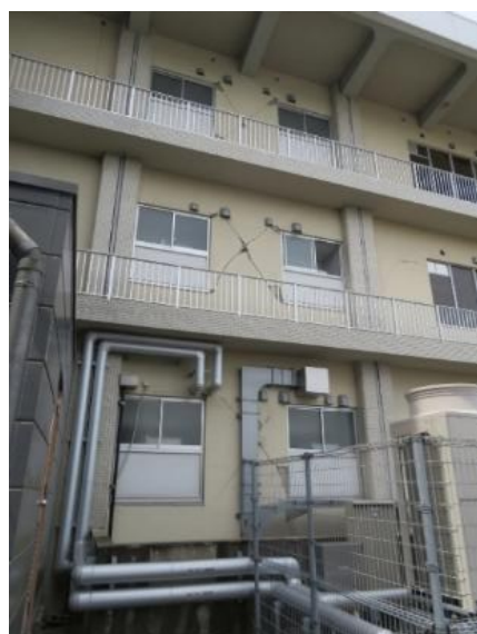
非構造壁のせん断ひび割れ
