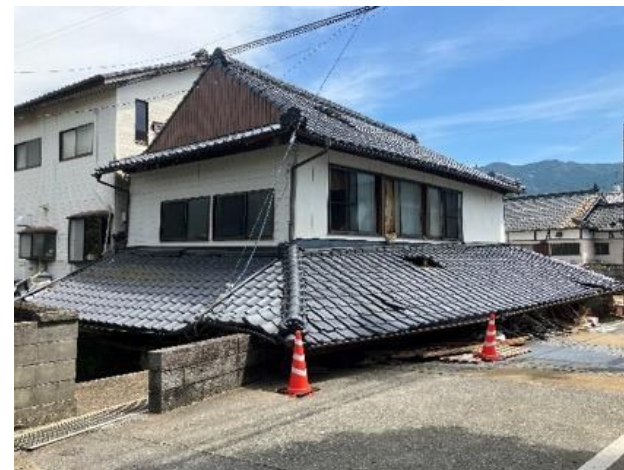
住宅の層崩壊
