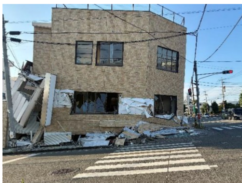
3階建てRC造建築物の層崩壊
