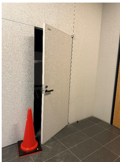
扉の開閉の支障
