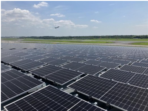
C8貨物屋上に設置 した太陽光パネル
