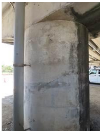
P7橋脚段落し部の せん断ひび割れ
