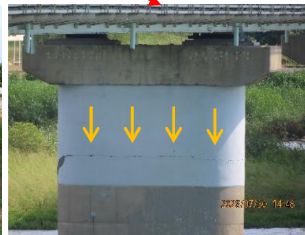
せん断補強を行った部分での 補強材の剥離と割れ
