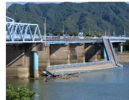
桁(歩道部)の落下
