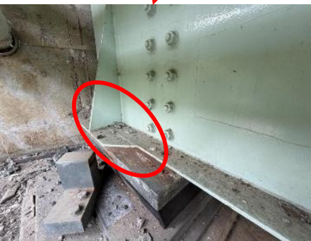
ゴム支承のボルトの破断
