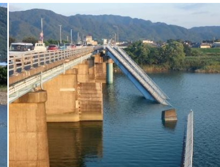
橋脚(歩道部)の倒壊
