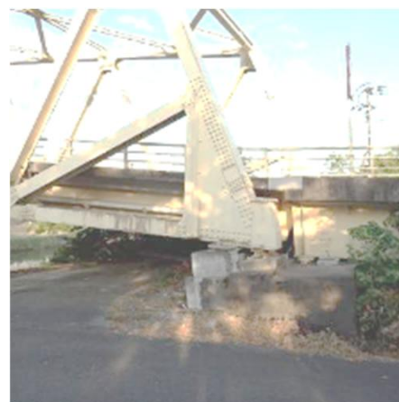
P2橋脚の沈下、傾斜
