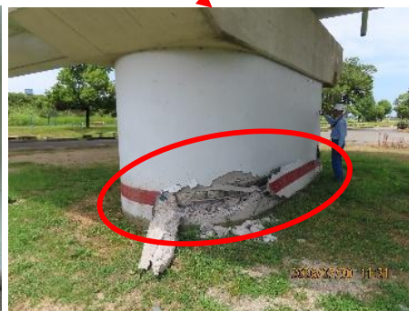
軸方向鉄筋の変形、かぶりコンクリートの損傷など 曲げ破壊と思われる損傷
