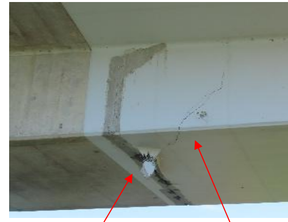
前回ひび割れ箇所、損傷進展
