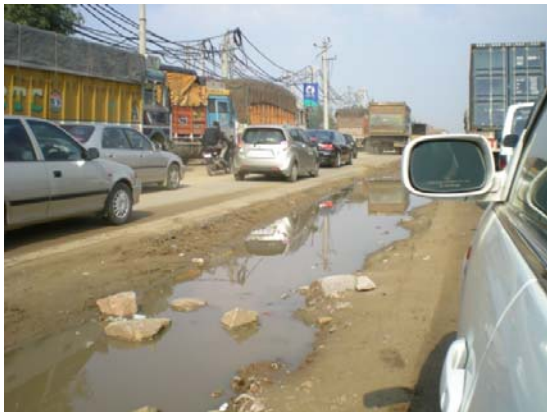
写真 NH8（デリー～ムンバイ間幹線道路） で車線を横断する未完成・未舗装区間
