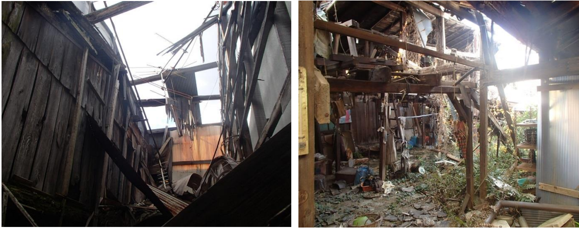
図 3-2-8 事例写真(代執行着手前(2014 年 11 月の状況))
