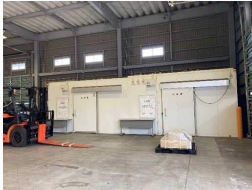
図 40 冷蔵庫及び冷凍庫(B. 国際貨物棟) 70
