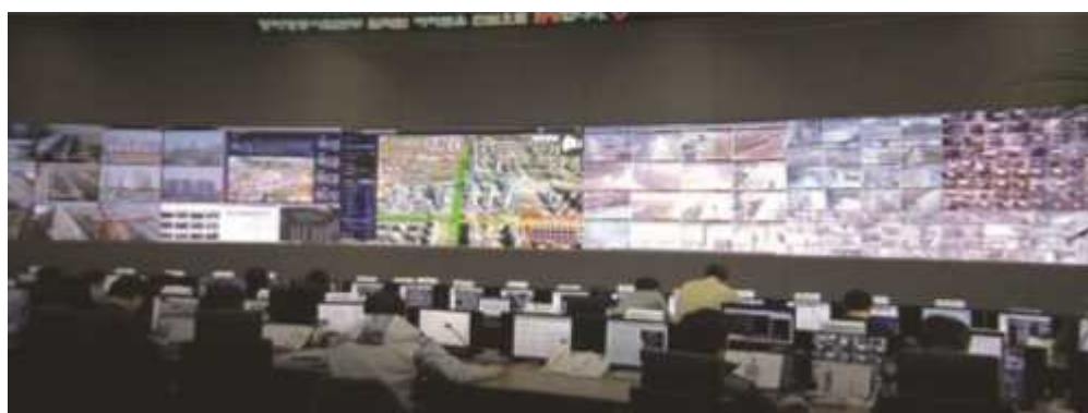
図5 IFEZ 統合オペレーションセンター 出所：Inter - American Development Bank
