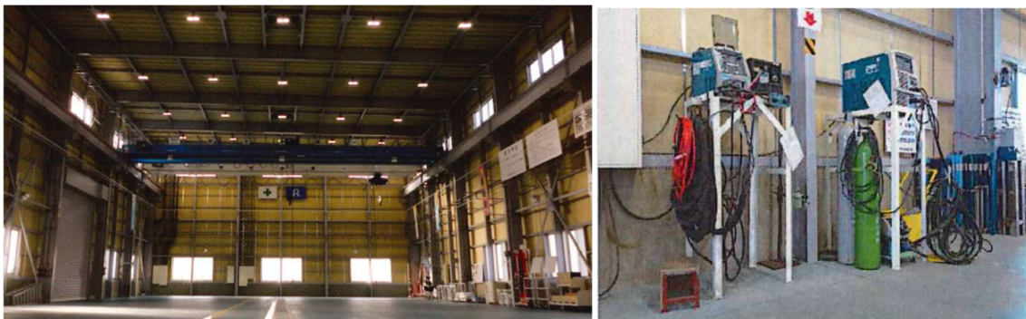
図－9. (株)羽田工業所の工場建屋内(左)とかさ上げた溶接機器(右)
