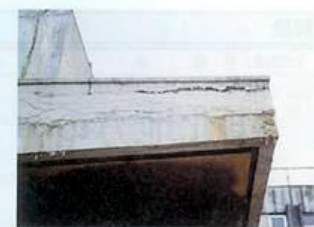
写真-3 長手方向ひび割れ ®
