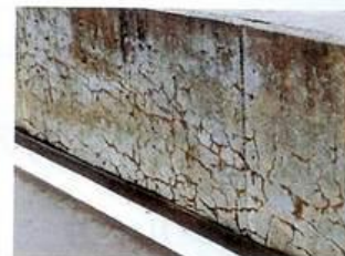
写真-2 パターンひび割れ ®
