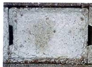
写真-1 D ひび割れ ®
