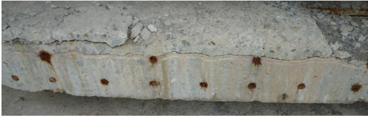
融雪剤の影響を受けて劣化した実RC床版
