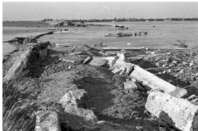
庄内川堤防決壊現場 (1959年9月28日撮影)
