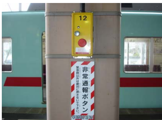
非常通報ボタン(ホーム)
