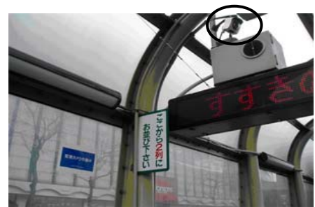
&lt;すすきの停留場監視カメラ設置状況&gt;
