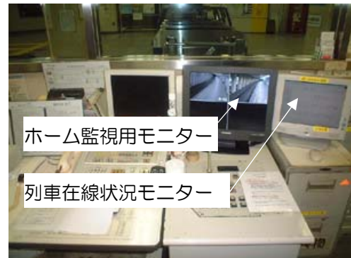
<モニター設置状況>
