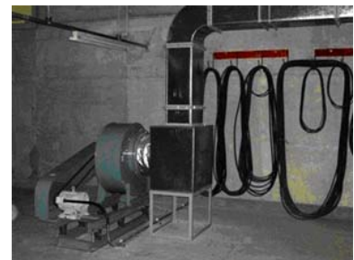
&lt;排煙設備整備&gt;
