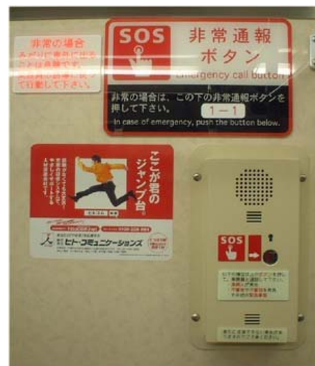
&lt;車内非常通報装置&gt;
