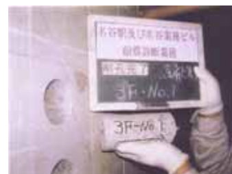
名谷駅及び名谷業務ビルの耐震診断業務
