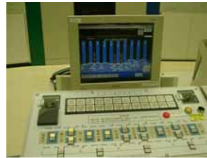
排煙操作卓 (運転指令)
