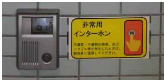
非常用インターホン(ホーム)
