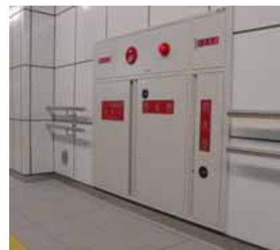
防火用散水栓
