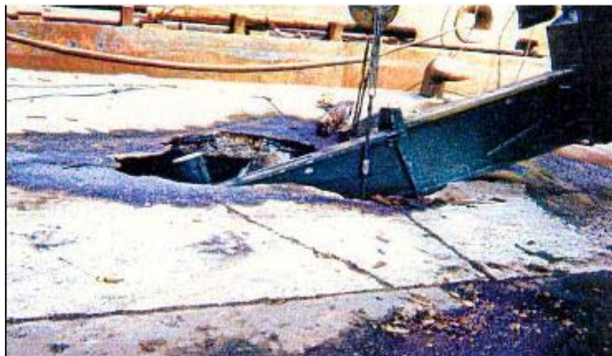
【岸壁エプロンの陥没部分】
