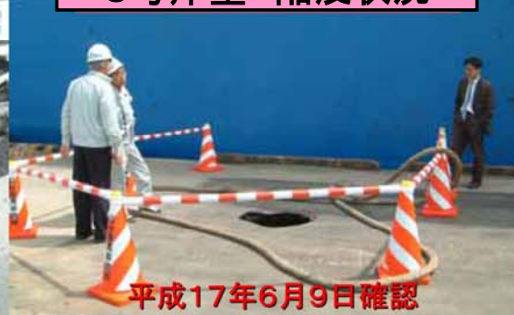
3号岸壁 陥没状況
