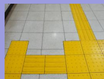
視覚障害者誘導用ブロック
