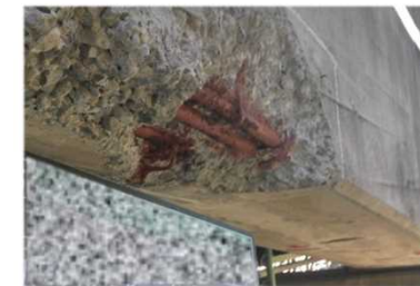
損傷状況(鉄筋露出)
