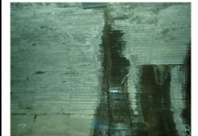
損傷状況(うき・漏水)
