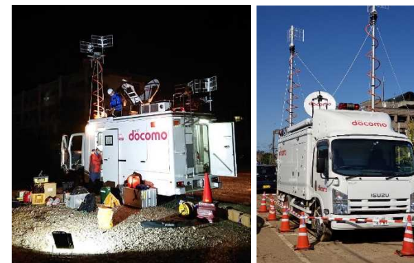
衛星通信による基地局の設置(NTTドコモHPより)
