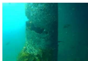
鋼管杭の腐食状況
