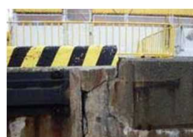
上部工の欠損状況
