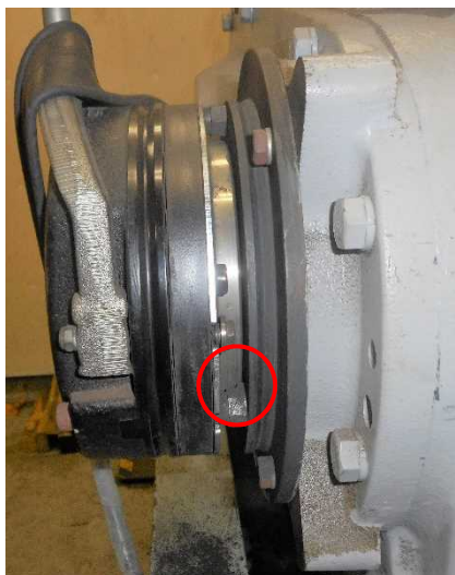
写真5. 堆積した摩耗粉 (ブレーキ側面部分)
