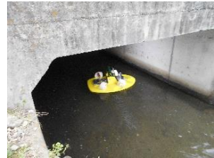
水上ドローンによる損傷把握
