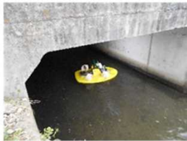
水上ドローンによる損傷把握
