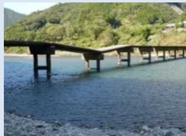
2017年11月に岩間沈下橋の一部がV字崩壊 (四万十市役所)
