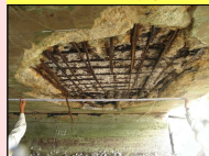
内部の鉄筋が露出した橋梁
