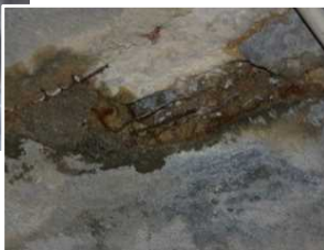
覆エコンクリートの剥落・貫通ひびわれ
