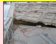
クラックが生じた河川護岸
