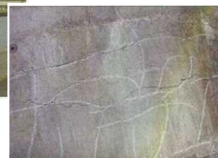
下部工のひび割れ
