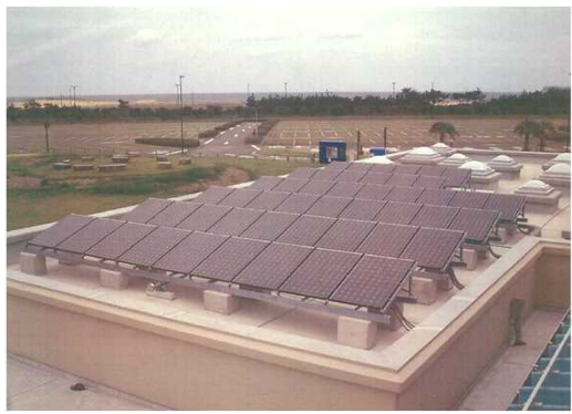
太陽光発電施設の設置イメージ
