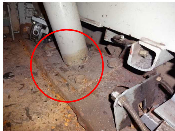
写真17. 取り付け台の錆や腐食
