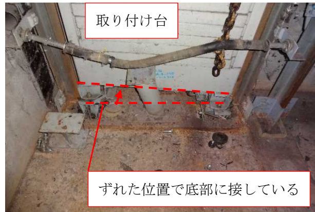
写真16. カウンターウェイトの状況 (写真15の緩衝器本体は外している)
