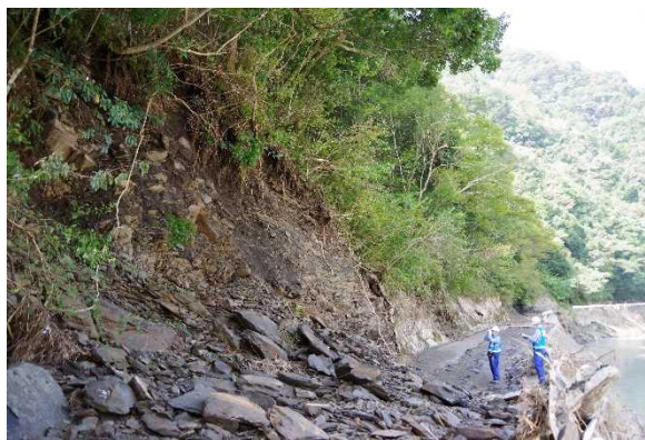
道路の法面崩落箇所における被災状況調査 (宮崎県西米良村 にしめらそん )
