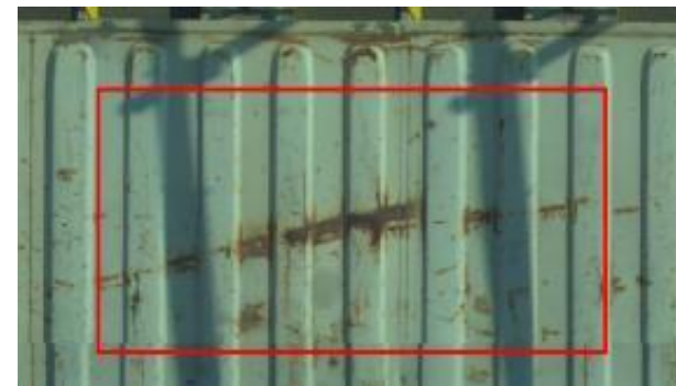
画像データの表示例 (赤枠:腐食ダメージ部)
