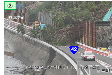
② 法面崩落の状況(R4.6) [串本町上浦地先]
