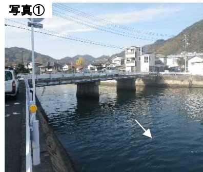
歩道が無く危険な安浦大橋 (1.7千台/日、歩道有効幅員0.75m程度)
