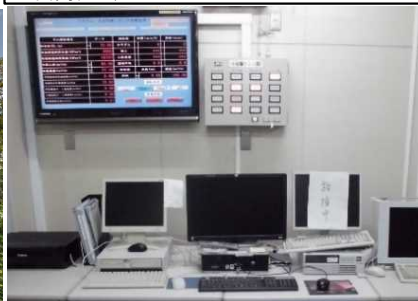
ダム管理用制御処理設備改良 (様似ダム、矢別ダム、美幌ダム、新中野ダム、小平ダム、栗山ダム、上ノ国ダム、庶路ダム、西岡ダム)
