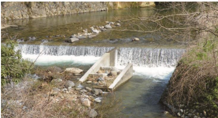
① 過去に設置された魚道が破損
