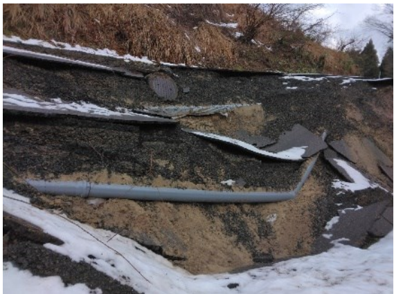
浄水場から配水池へ向かう水道管の破損・露出（輪島市）
