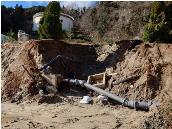
浄水場内の配管損傷（七尾市）
