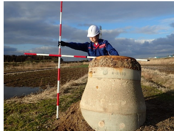
マンホール浮上現場（中能登町）
