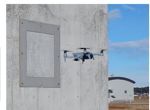
ドローンによる損傷把握
