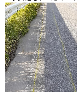
区画線の摩耗
