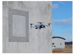
ドローンによる損傷把握
