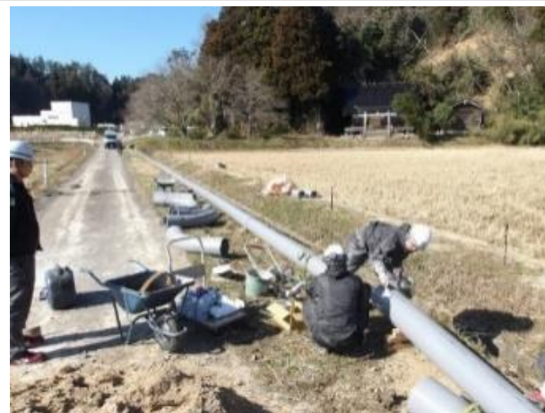
下水を集約し処理場へ送る圧送管の被災現場（珠州市）
