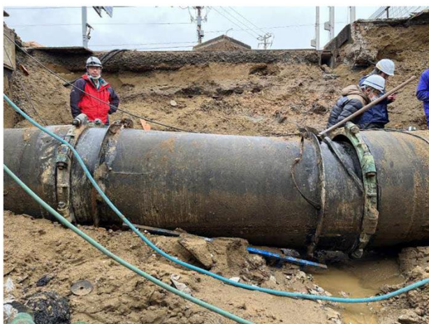
送水管の被害（七尾市）
