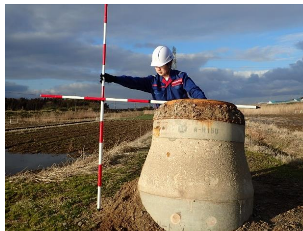
マンホール浮上現場（中能登町）
