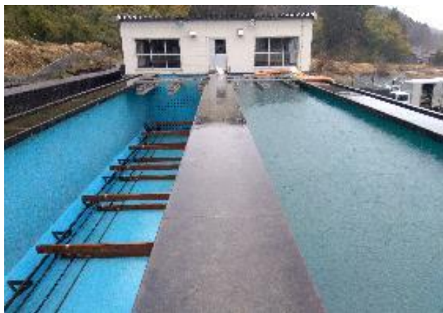
浄水場の被害（珠州市）
