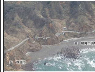
③大川浜工区 (地震被災状況 R6. 1)
