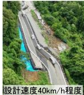
能越道での段階的な復旧イメージ
