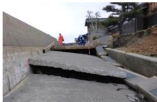
護岸・水叩き損傷
