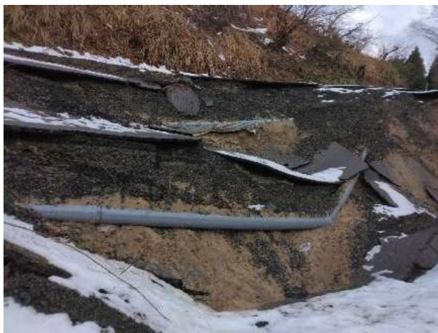
浄水場から配水池へ向かう水道管の破損・露出
