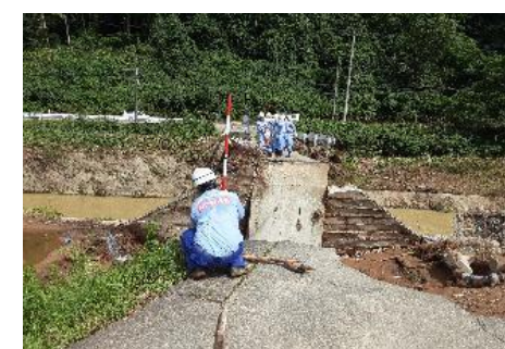
被災状況調査(道路) (山形県鮭川村)
