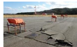
能登空港の被災状況
