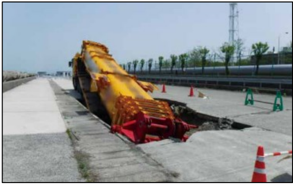
埋立護岸による陥没の発生状況
