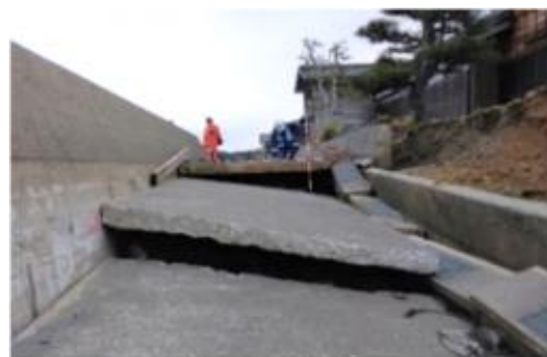
護岸・水叩き損傷
